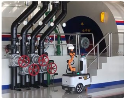
主厂房辅机设备巡检
